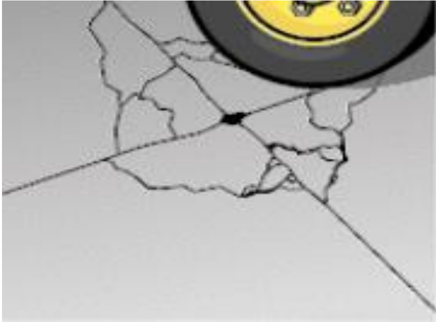
Figure 10: Diagonal cracking (Kumar, 2000)
