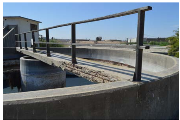
(d) Pond bridge with corrosion damage
