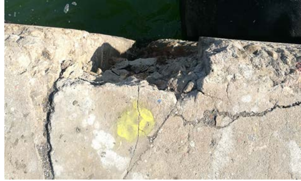
(d) concrete spalling
