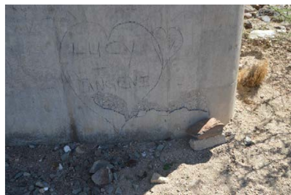
(d) Cracked pier
