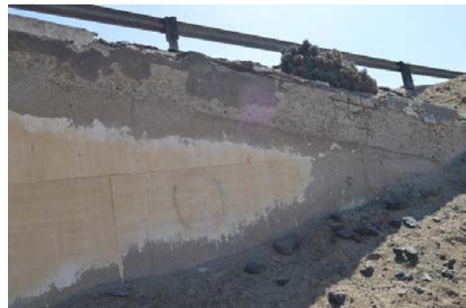
(d) Cracked wingwall
